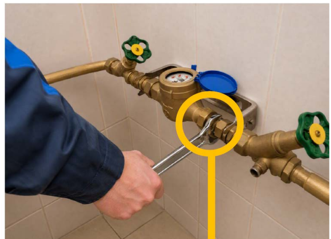
Öffnen der beiden Holländer-Verschraubungen des alten 175 mm Nassläufer Mehrstrahl Kaltwasserzählers.
