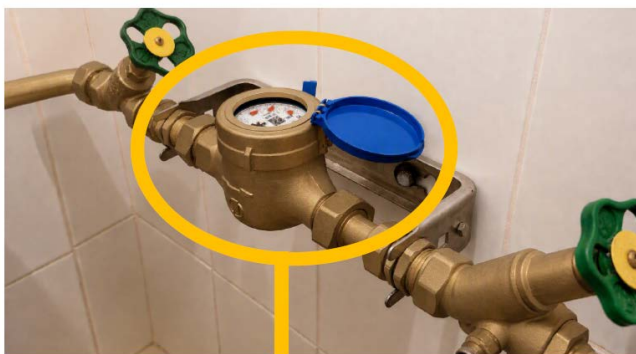
Ein alter Nassläufer Mehrstrahl-Wasserzähler für Kaltwasser der in einem österreichischem Wasserzählerbügel mit einer Einbaulänge von 175 mm eingebaut ist.
