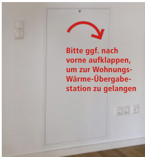
Beispiel: Wohnungs-Wärme-Übergabestation in Unterputzschrank eingebaut (Öffnung nach vorne)
