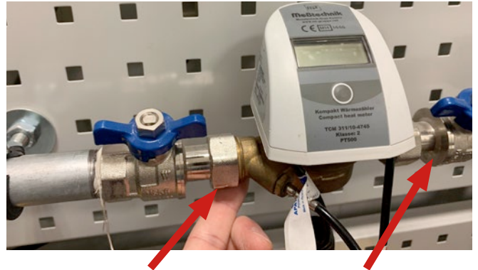
Kontrollbereich rechts und links des Wärmezählers
