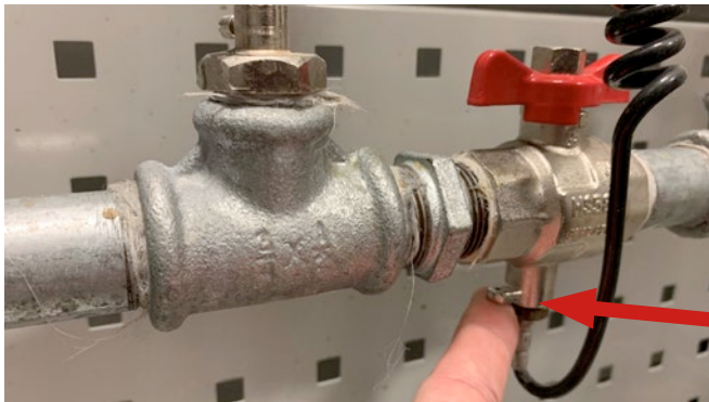
Kontrollbereich am Temperaturfühler des Wärmezählers (mit einem Kabel mit dem Wärmezähler verbunden)
