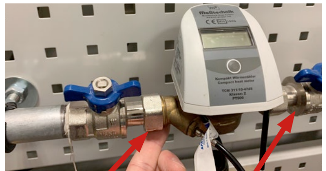
Kontrollbereich rechts und links des Wärmezählers
